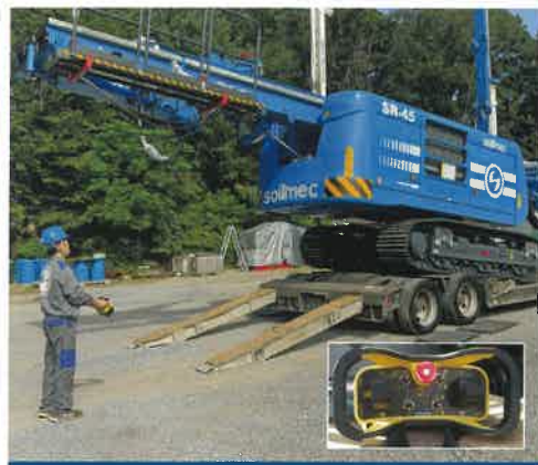
リモコンによる安全な積込・積み降ろし作業
