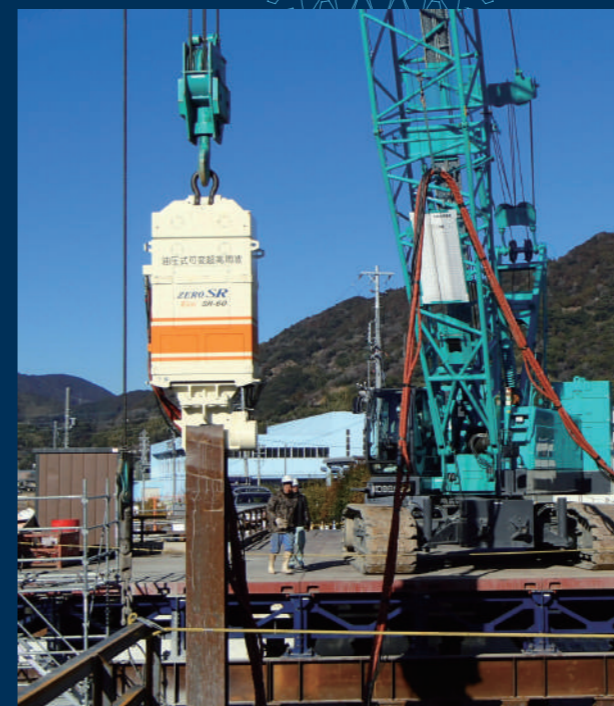
工事名: 三輪立花線(横内)橋梁下部工(橋脚)工事 杭規格: 400H(L=32.0m) 発注: 静岡県藤枝市
